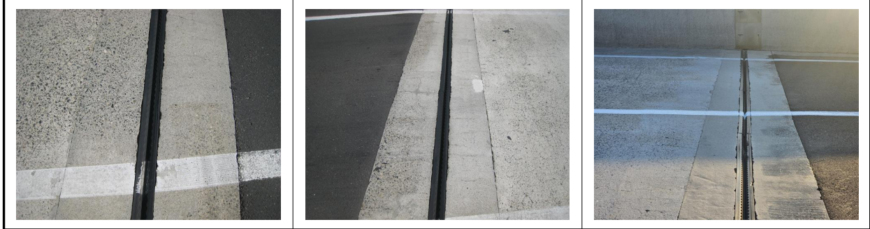
② 신축이음 A1, A2측 후타재 균열, 후타재 박락, 고무재 파손 - 진전 여부확인
